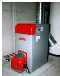
Caldera de Gasoil
